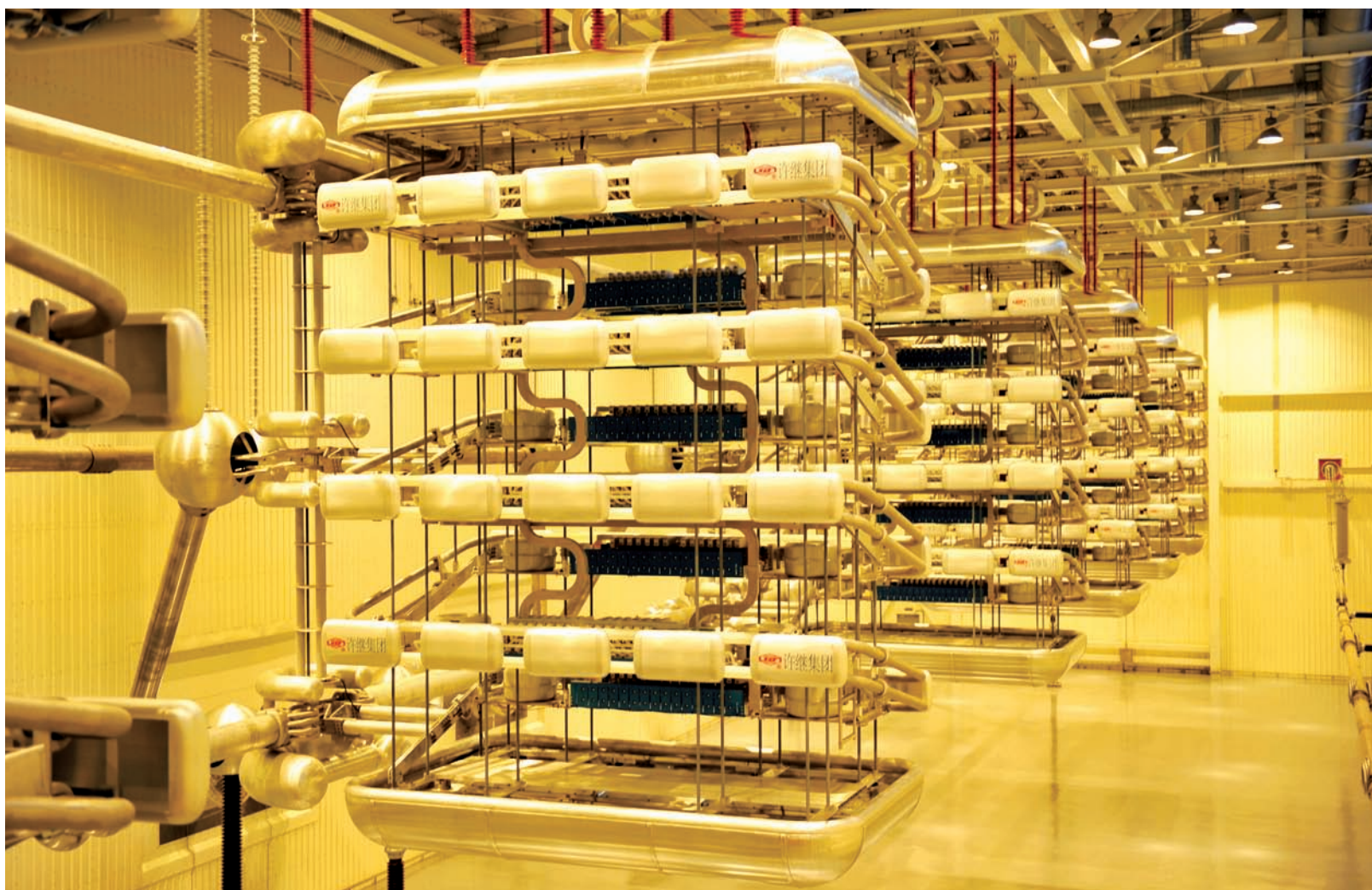
图19 许继集团生产的锦屏—苏南±800kV特高压直流输电工程同里换流站阀厅
