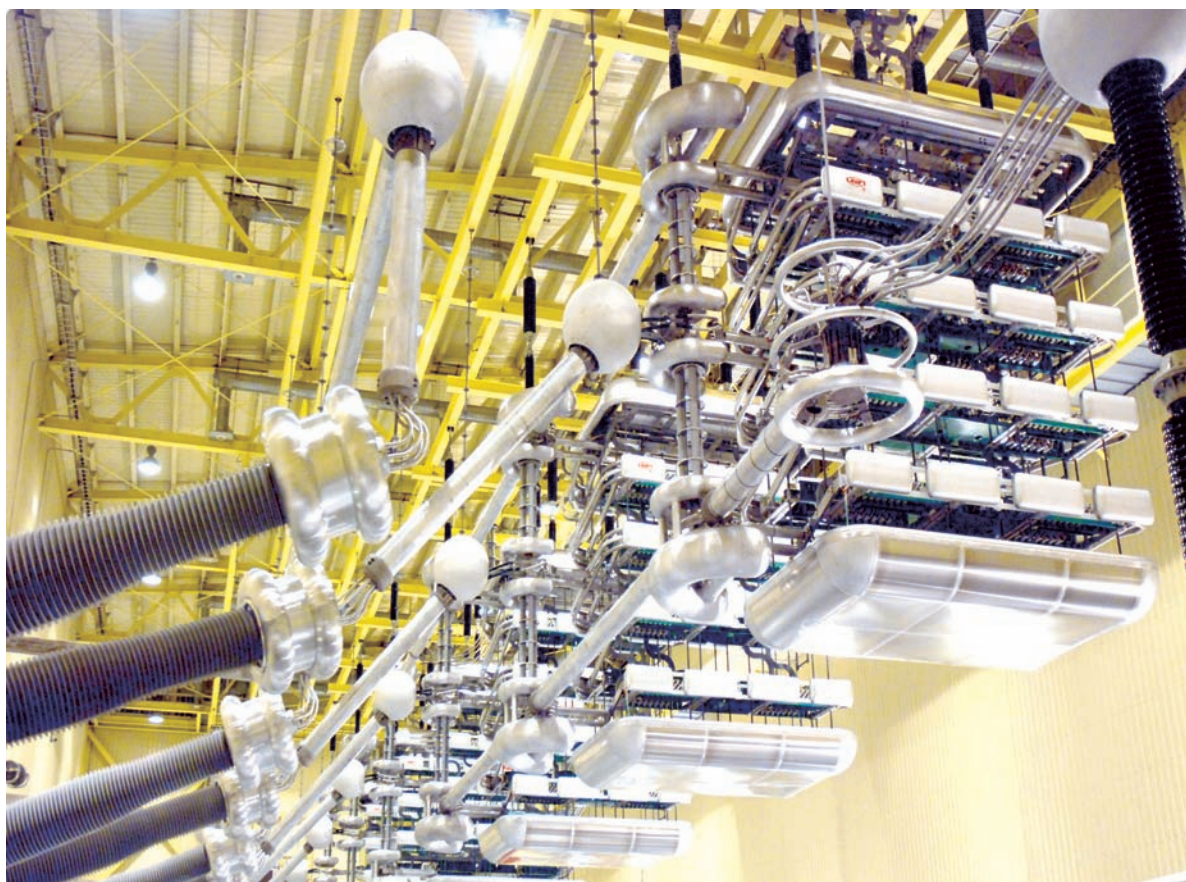
图15 许继集团生产的向家坝—上海±800kV特高压直流输电示范工程奉贤换流站阀厅
