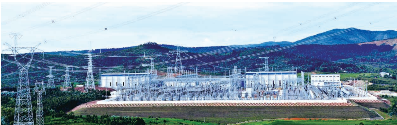
图11 云南楚雄±800 kV特高压直流输电示范工程换流站全景
