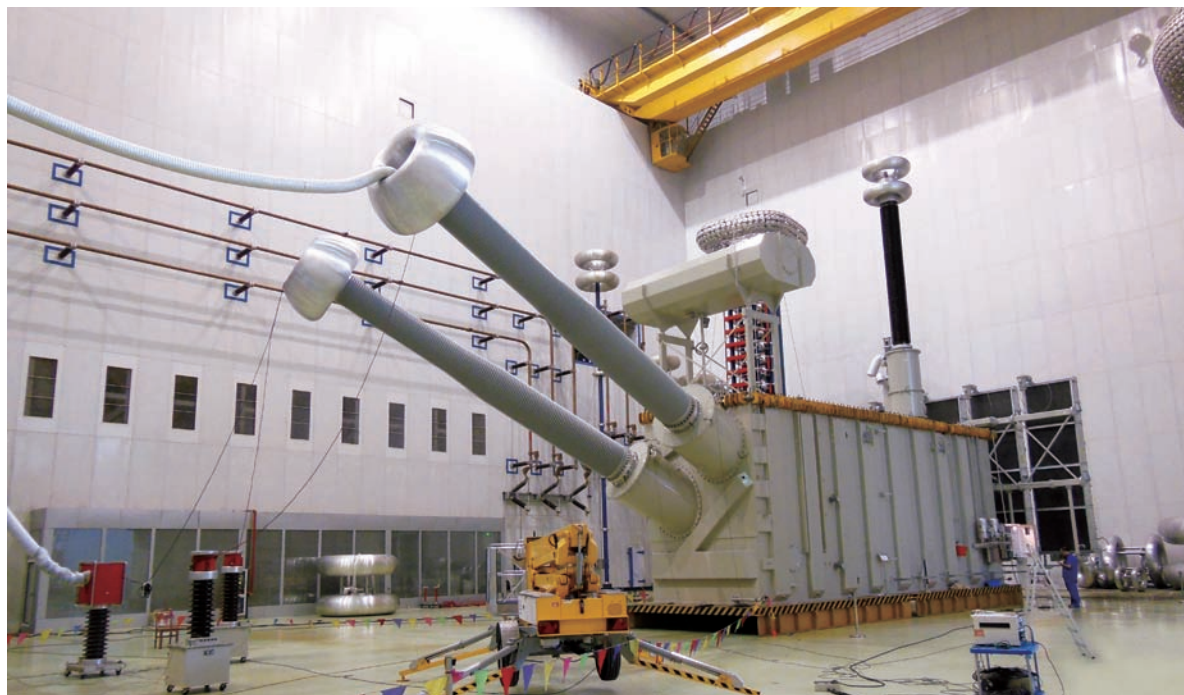
图16 西变公司生产的锦屏—苏南±800kV特高压直流输电工程换流变压器
